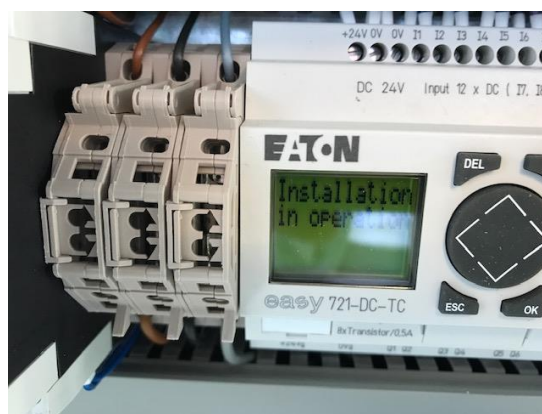
Installatie in bedrijf
