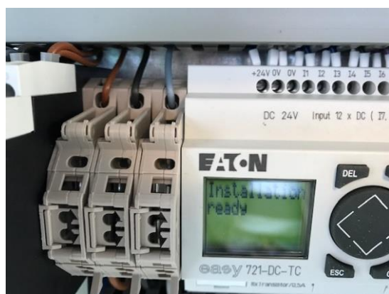
Installatie gereed voor bedrijf
