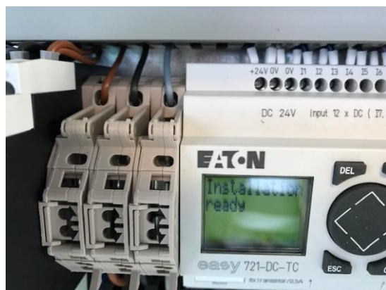
Installatie gereed voor bedrijf
